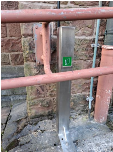
Eingangsschalter zur Türöffnung
