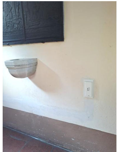
Ausgangsschalter zur Türöffnung beim Herausgehen
