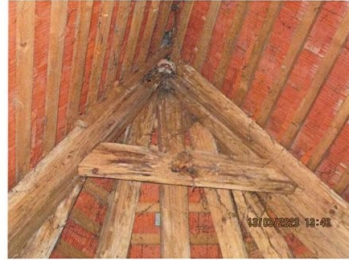
Abbildung 49: Schadhafter Firstpunkt (Anfallspunkt) in Achse 15
