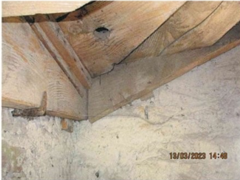
Abbildung 71: Abgesackte Treppenwange im Turm unterhalb der Glockenstube
