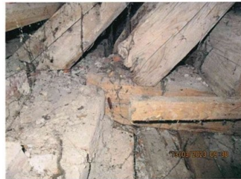
Abbildung 14: Schadhafter Fußpunkt, Nordseite Achse 8
