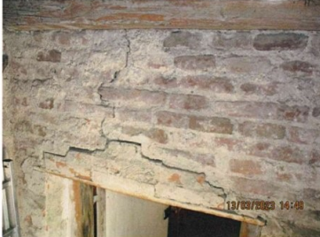
Abbildung 72: Fehrender Türsturz über der Türe von der Empore in den Turm
