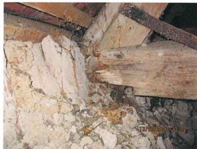
Abbildung 39: Schadhafter Fußpunkt Nordseite Achse 14
