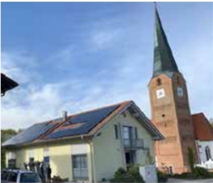
fertig montierte PV-Anlage Ende Oktober 23'
